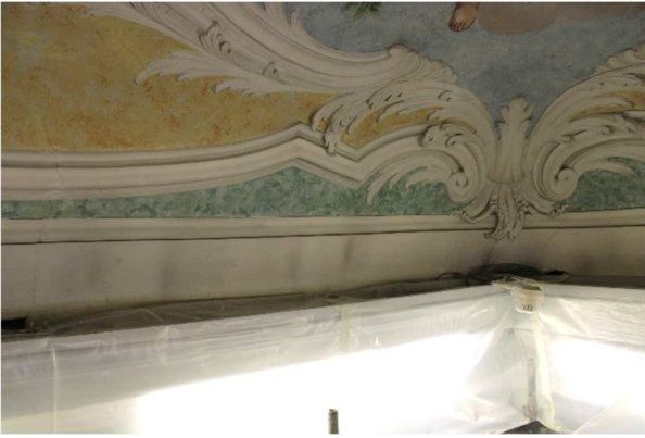
Figura 11 – Escurecimento da camada policroma na zona da sanca, resultante do aquecimento provocado por um sistema de iluminação entretanto desativado.
