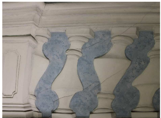
Figura 6 – Fissuras ao nível do revestimento em estuque.
