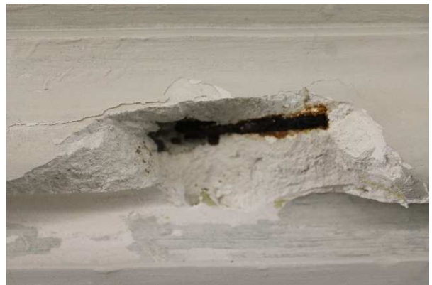
Figura 10 – Presença de elementos metálicos oxidados, decorrentes de intervenções anteriores.
